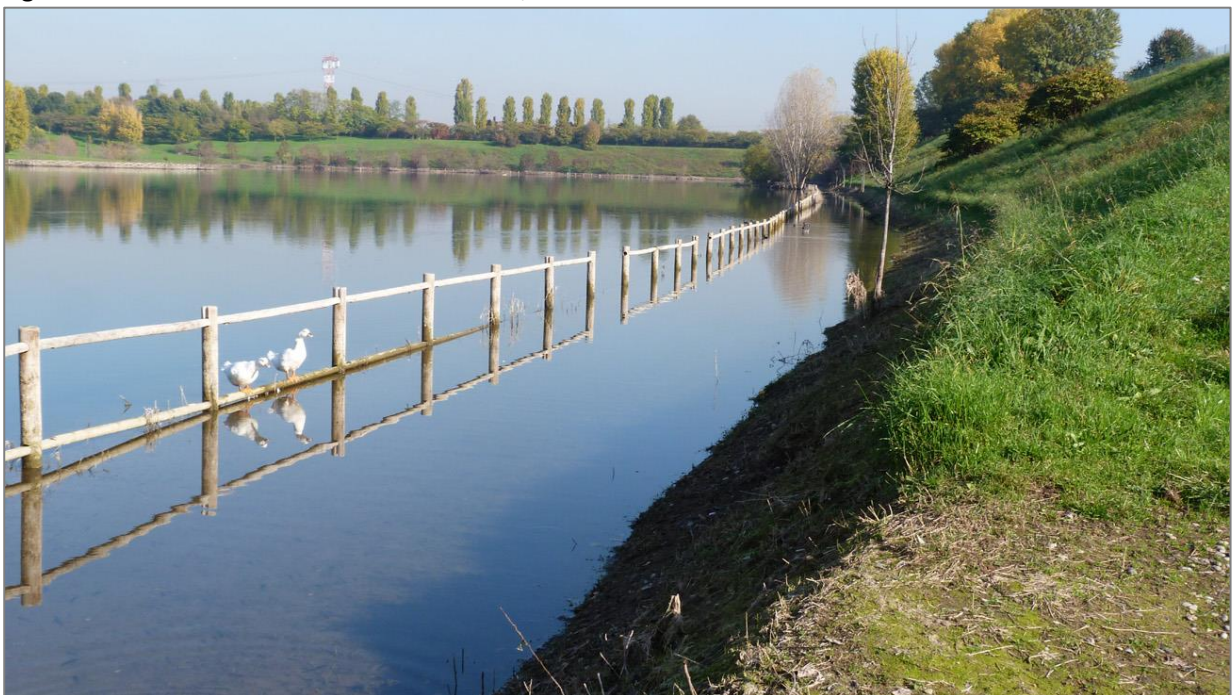
Fig. 45 Con falda molto alta viene sommerso il percorso perimetrale e si incrementa l'erosione (foto 30/10/2015)
